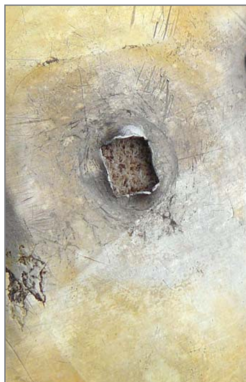
Quadratisches Loch an der Unterseite. Bearbeitungsspuren im Blech.
